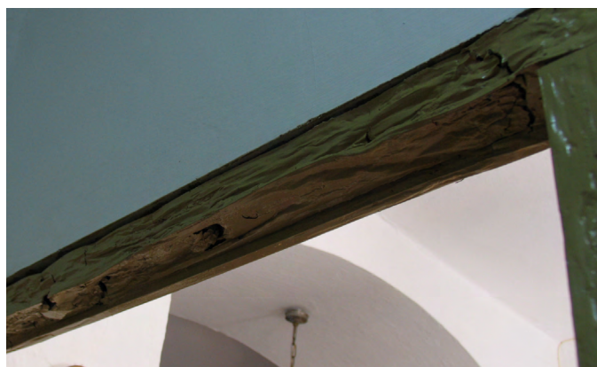
Figura 1. Ejemplo de daños que pueden causar las termitas. Se aprecia la destrucción que han provocado en la parte superior del marco de una puerta.
